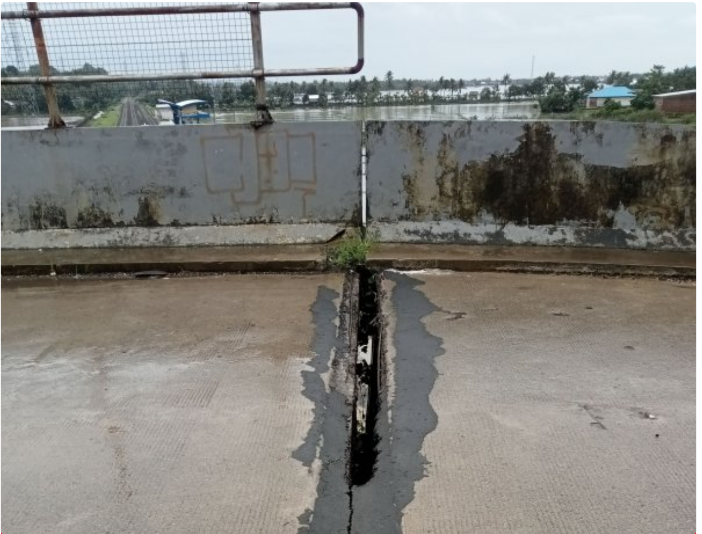
Sambungan jalan fly over Pekkae rusak parah
